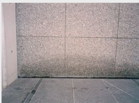
○床の据え付け後濡れ色発生
