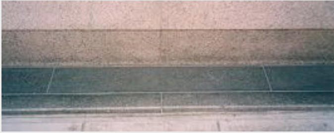
○20年の煤煙・歩行等による汚れ
