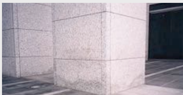
○竣工後2年、吸い上げによる濡れ色
